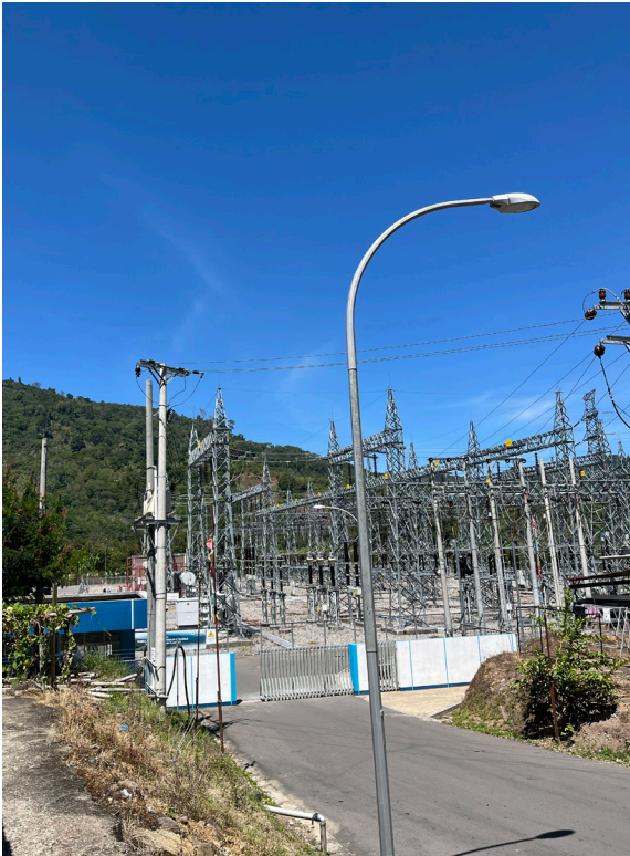
Pembangkit Listrik Tenaga Air Kec Silih Nara, Aceh Tengah. (Dok. ACCI USK)
